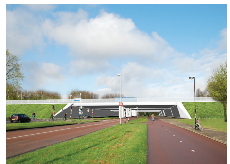
Boven: De bestaande onderdoorgang ter hoogte van de Leuvenlaan, gezien vanaf de Uithofzijde. Onder: Een visualisatie van een mogelijke vormgeving van het viaduct na verbreding van de A27.
